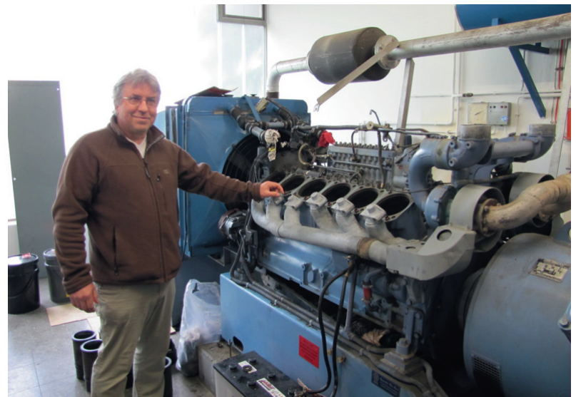
Klärwärter Harald Schumacher vor einem der beiden Notstromaggregate
