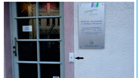
Elektrischer Türöffner auf der rechten Seite des Hintereingangs
