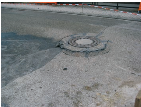
die Straße wurde unterspült und ist großflächig abgesackt.
