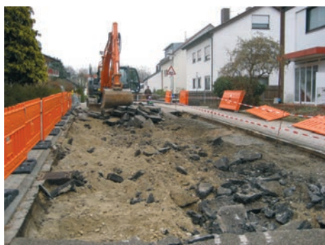
Der Wasserrohrbruch zieht eine größere Baumaßnahme nach sich.
