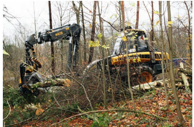
Ein Waldvollernter räumt die Bäume ab für den ersten Bauabschnitt des Lärmschutzwalls
