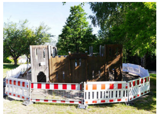
Kein Eintritt in die Burg Schmalenstein - Das Spielgerät ist baufällig.
