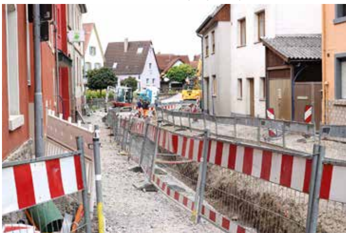
Bild aus der Jöhlinger Straße: Die Baumaßnahmen in Weingarten machen einen großen Teil des Investitionsvolumens aus.
