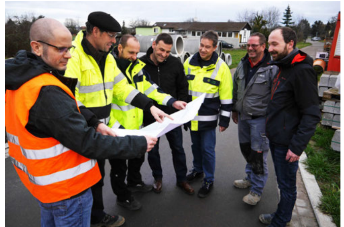
„Gerd Weinbrecht, Tiefbauleiter der Gemeinde Weingarten (schwarze Jacke, Mitte) und Bauleiter Jan Schmitzer (ganz rechts) besprechen gemeinsam mit den Kollegen die nächsten Schritte.“
