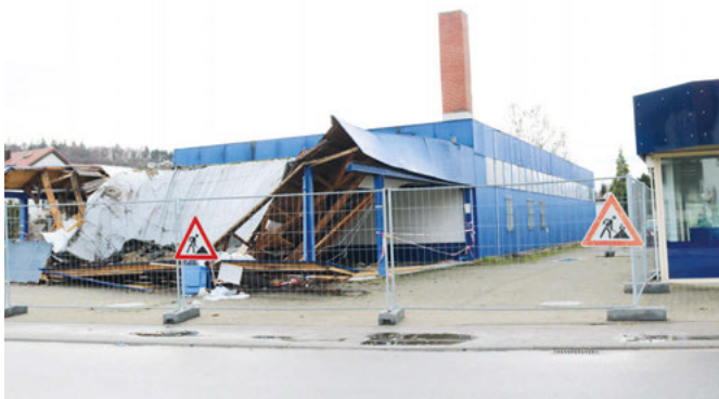
Das Vordach ist auf der ganzen Breitseite abgebrochen, weil die Holzkonstruktion nachgegeben hat
