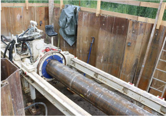
Im Rohr drin befindet sich ein lasergesteuerter Schneckenbohrer, der sich durch das Erdreich unter dem Bahndamm durchfrisst.
