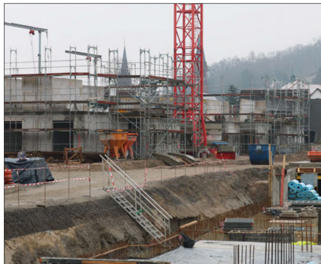
links entstehen die beiden Flügel des Pflegeheims, rechts die Baugrube der künftigen Mehrfamilienhäuser
