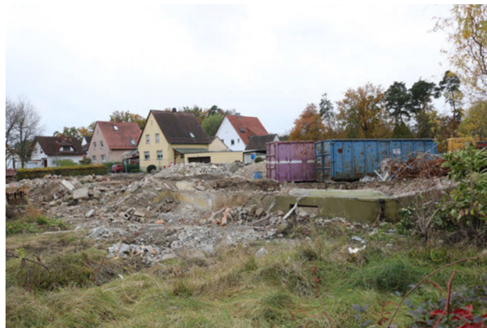
Der vorhabenbezogene Bebauungsplan „Ulmenplatz“ umfasst auch Teile des Eichenweges. Hier wurden die alten Siedlungshäuser bereits abgerissen.
