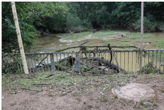
Astmateriale hat sich am Einlassrechen gefangen, der Pegel im Schlossbergsee dürfte die 2-Meter-Marke erreicht haben
